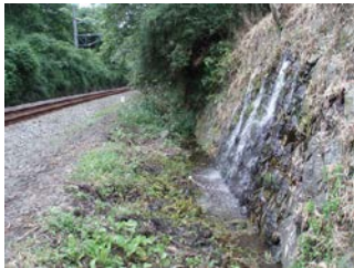
写真-1 石積土留壁からの出水状況
