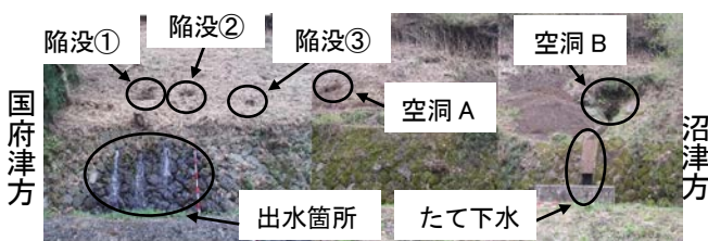
写真-2 切取斜面の空洞および陥没の位置
