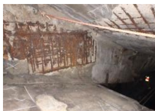
図-2 ダクト下部変状写真
