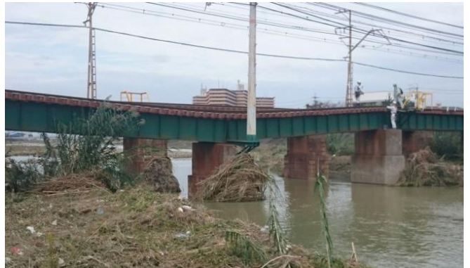
写真-1 男里川橋梁の被災状況
