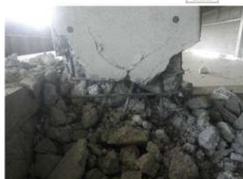
写真-2 支柱損壊状況
