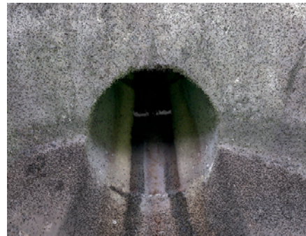
図-3 MH 内管口
