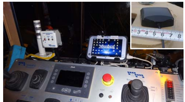
写真-1 機器設置状況 (タブレット、パトライト、アンテナ)
