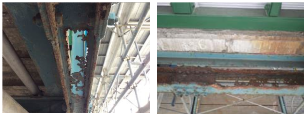
図-1 下弦材の損傷
