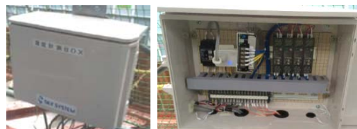
写真-1 コンクリート養生温湿度計測システム
