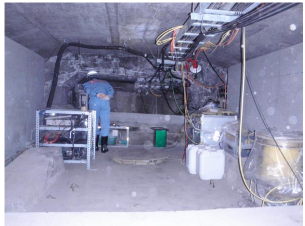
写真1 妙高大橋 PC 箱桁内部劣化とモニタリング状況
