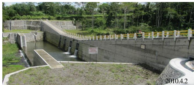
図1 越流を前提とした橋梁。砂防ダムを兼ねている(メラピ火山緊急防災)。
