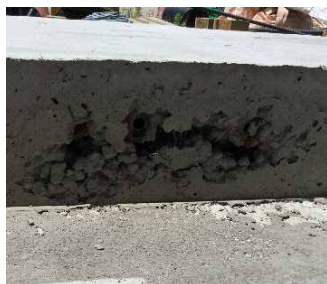
写真-2 豆板の発生
