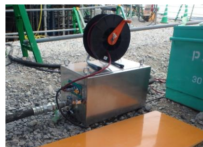
写真-2 注入管理装置
