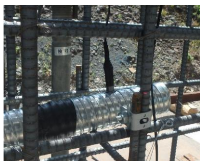
写真-4 充填検知センサー
