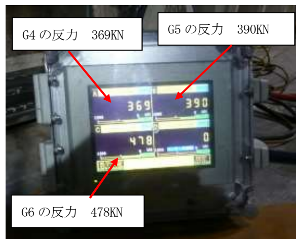
写真-1 デジタル荷重計の反力表示例
