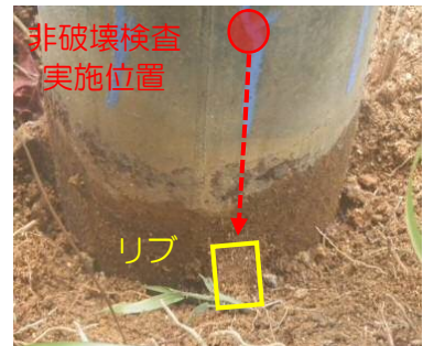
図-3 超音波の伝搬不良の原因
