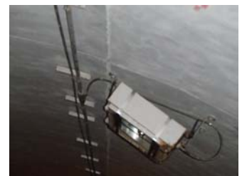
図-2 照明設置状況
