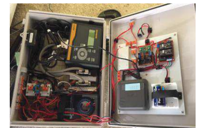
図 3. モニタリングシステム測定部状況
