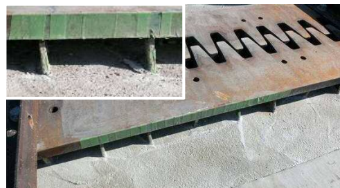
図3 アンカープレート破断確認状況
