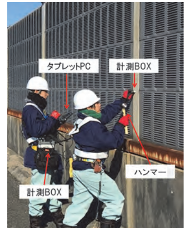
図1 AE センサを用いた打音検査装置
