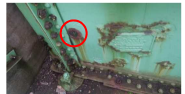
図2 腹板中間高さでの局所的な孔食
