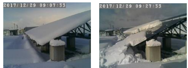
図 9 雪の崩落前後の現場写真
