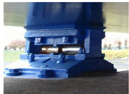
図 12 鋼製支承(カバー紛失)
