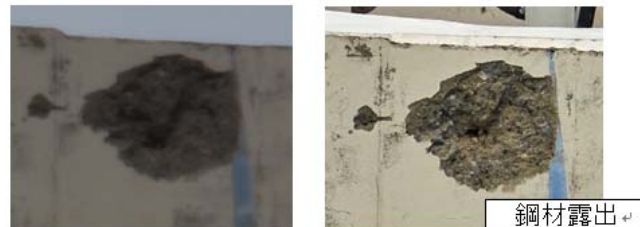
写真-3 煙突頂部剥離の比較(左:地上画像、右:空撮画像)
