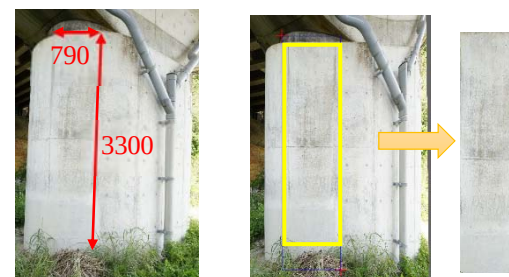
①型枠跡 1 列毎に補正 ②補正後トリミング
