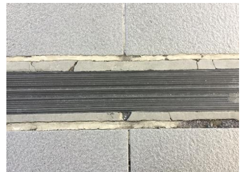
図 2 発生した間詰材のひび割れ
