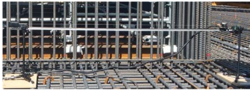
写真2 試験装置の配置状況
