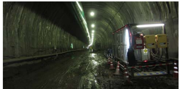
写真-2 トンネル内の状況(壁面・底面とも湿潤)
