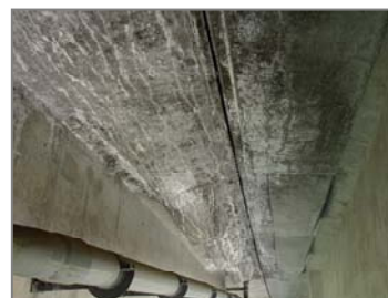
写真-2 一次床版下面劣化状況
