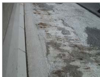
写真-1 一次床版上面劣化状況
