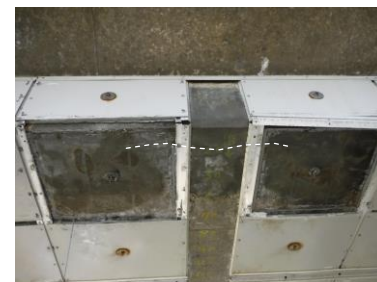
図-5 ひび割れ①の状況
