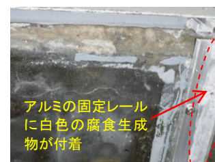
図-7 腐食生成物
