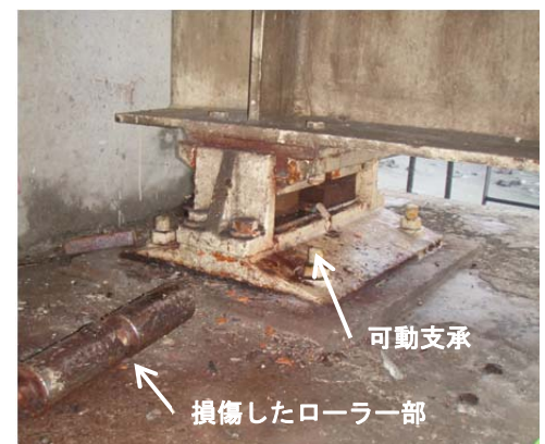
写真 - 1 既設支承損傷状況
