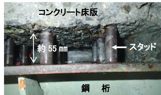
写真-5 鋼桁と床版の分離状況(阿倍野)
