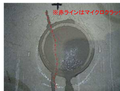
図-3 断面修復部のマイクロクラック
