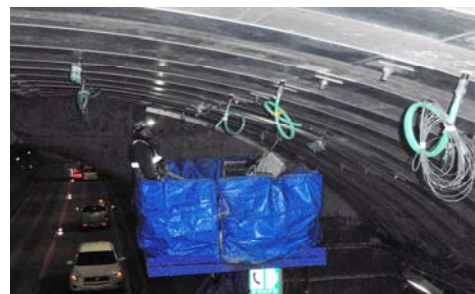
写真-3 注入管および光ファイバー
