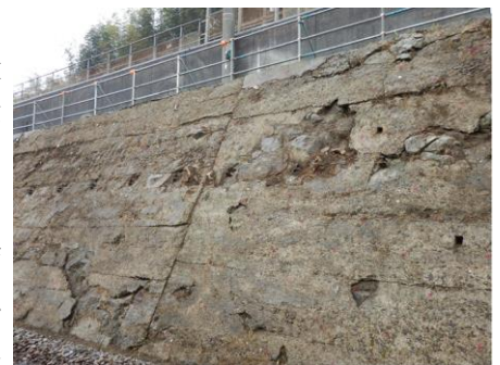
図 2 張コンクリートの表面剥離 (高圧洗浄後)
