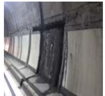
写真2 トンネルの劣化状況
