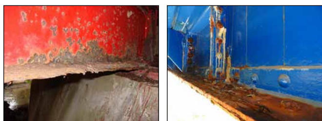
図-1 鋼桁下フランジ付近の腐食
