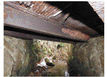
写真1 主桁腐食状況
