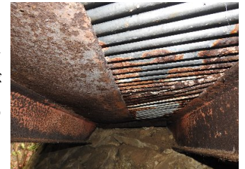
写真2 床版腐食状況
