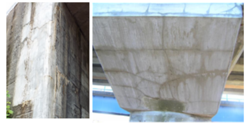
図－3: 断面修復工の再劣化状況
