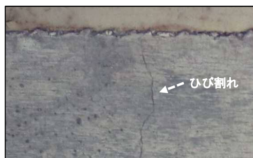
写真-2 床版下面の撮影画像拡大
