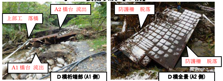
写 5 損傷状況【D橋】
