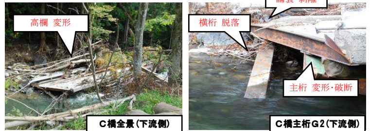
写 4 損傷状況【C橋】
