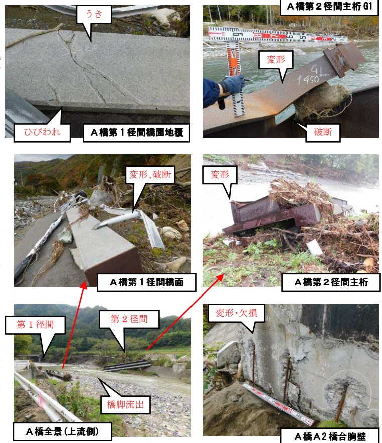
写 2 損傷状況【A 橋】
