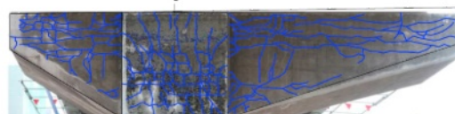
写真-1 梁部 ASR 劣化状況
