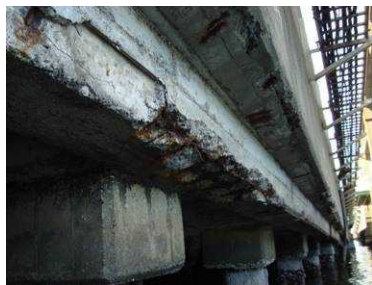
写真-1 東品川栈橋損傷状況
