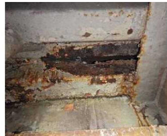
図-12 テッキプレート端部の腐食・欠損
