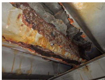
図-9 デッキプレートの著しい腐食 (補修済み)
