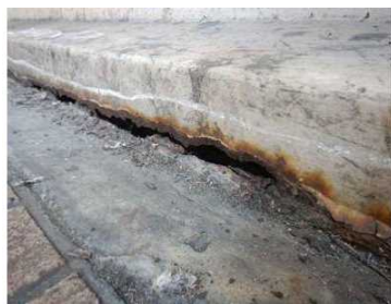
図-11 地覆の腐食（孔食）
