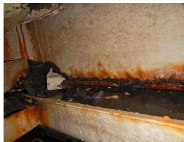
図-3 主桁下フランジの滞水・腐食
