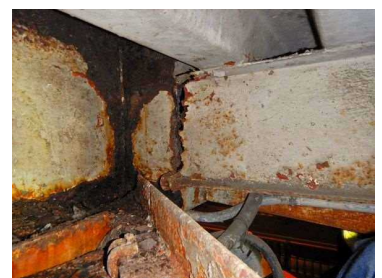
図-4 横桁の腐食・破断
