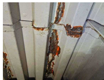
図-5 デッキプレートの腐食・欠損
