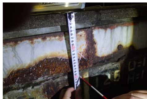
写真1 アングル材腐食状況
