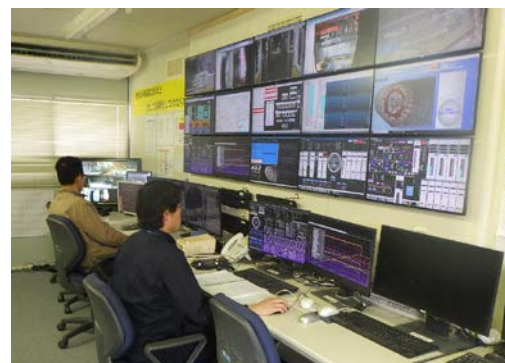
写真-1 中央管理室
