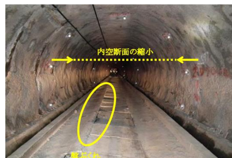
図-1 変状の状況
