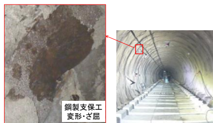
図-5 鋼製支保工の変形・ざ屈
