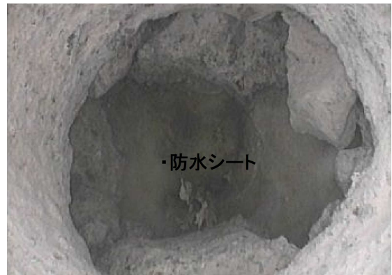
写真-3 防水シート状況
