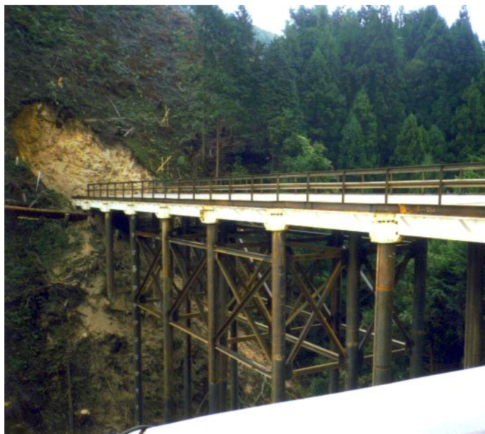
写真1 鳥取県西部地震に耐えた仮栈橋
