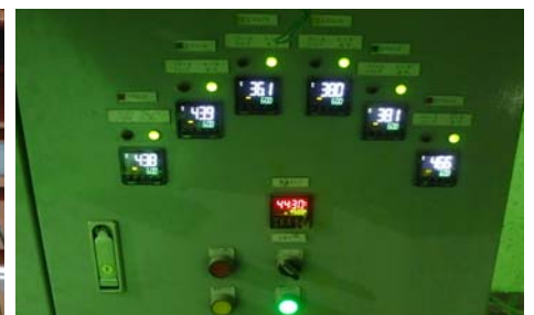
写真-2 温度設定制御盤
