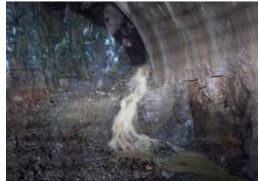
写真－1 突発湧水発生状況
