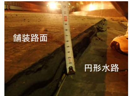
写真-1 路面隆起状況
